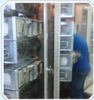
مجری طرح‌های اصلاح و بهینه‌سازی و تعمیرات اساسی شرکت برق منطقه‌ای یزد از تکمیل پروژه اصلاح و بهینه‌سازی حفاظت فیدرهای پست ۲۳۰ کیلوولت چادرملو و برق‌دار شدن آن خبر داد.
