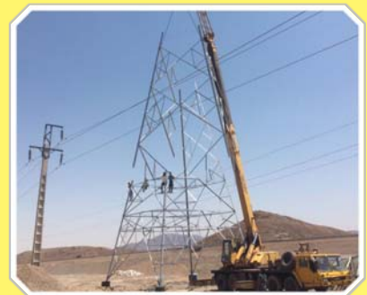
رئیس گروه نظارت بر تعمیرات خط دفتر فنی انتقال شرکت برق منطقه‌ای یزد از اجرای پروژه افزایش ارتفاع خطوط ۶۳ کیلوولت سورمق- ابرکوه به دلیل تلاقی با پروژه ملی احداث راه آهن یزد- اقلید خبر داد.
